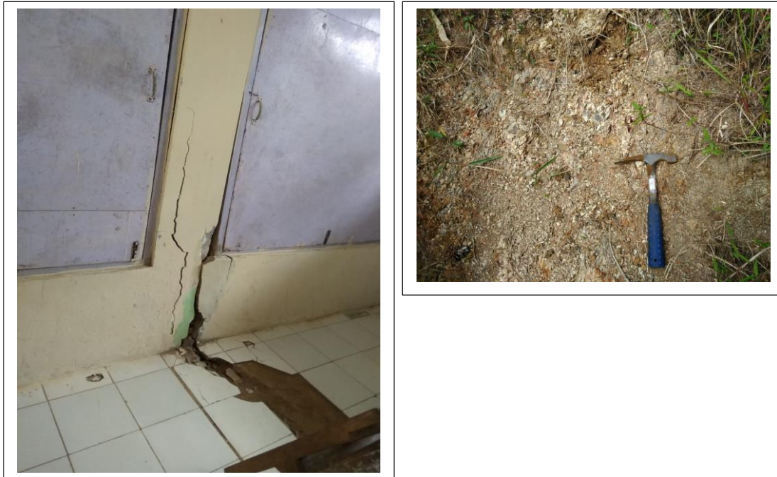
Gambar 5. Retakan mengenai bangunan di SD Jingsang dan tanah lempung sebagai material penyebab longsor (kategori zona 4-6)
