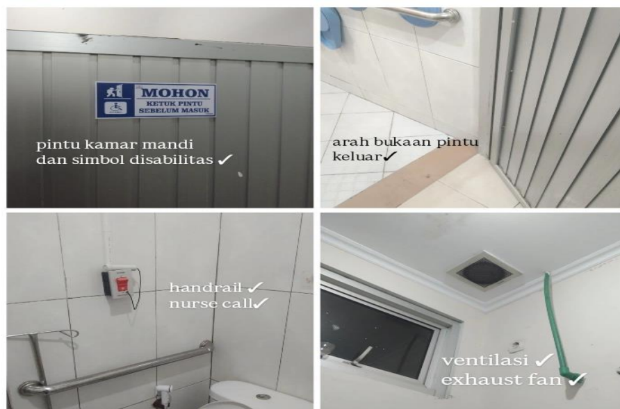
Gambar 2. Standar Kamar Mandi Ruang Rawat Inap
